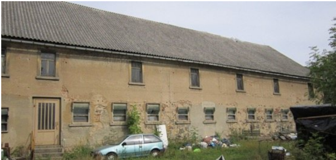
Stall, derzeitiger Zustand unsaniert, Hofseite
